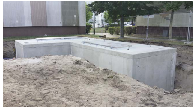
Abb. 13.4: Je nach System wird die im Betonfertigteilwerk hergestellte Raumzelle für die Technische Gebäudeausrüstung (TGA) in eine Baugrube gesetzt.
