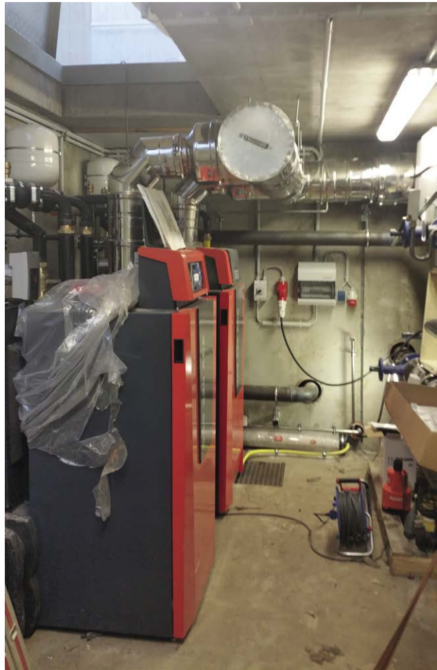
Abb. 13.7: Technische Anlagen arbeiten Tag und Nacht – allerdings nicht geräuschlos. Die Raumzelle für die Technische Gebäudeausrüstung ist aber weit genug entfernt vom sensiblen Wohnbereich.
