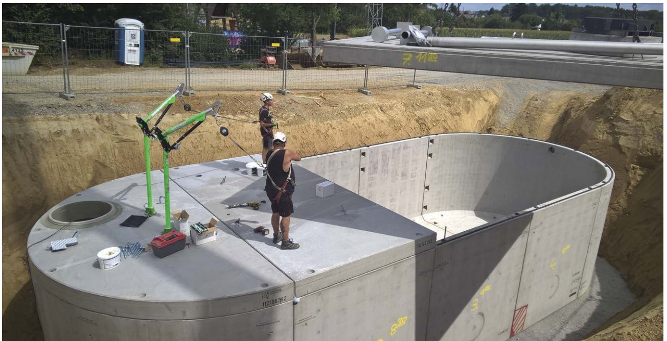
Abb. 13.1: Betonbehälter als Löschwasserbehälter
